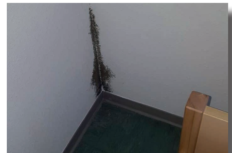
Massiver Schimmelbefall am Kopfende eines Bettes.
